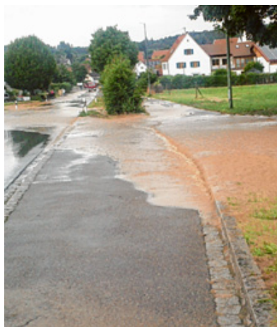
Durch ein heftiges Unwetter wurde die Staatsstraße bei Ettenbeuren überflutet. Foto: Wolfgang Kahler
